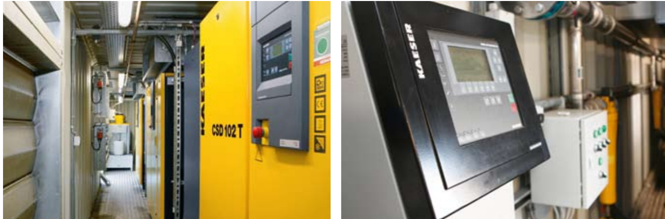
Снабжение сжатым воздухом и тепловой энергией для подогрева воды обеспечивает контейнерная компрессорная станция, управляемая «Sigma Air Manager»
